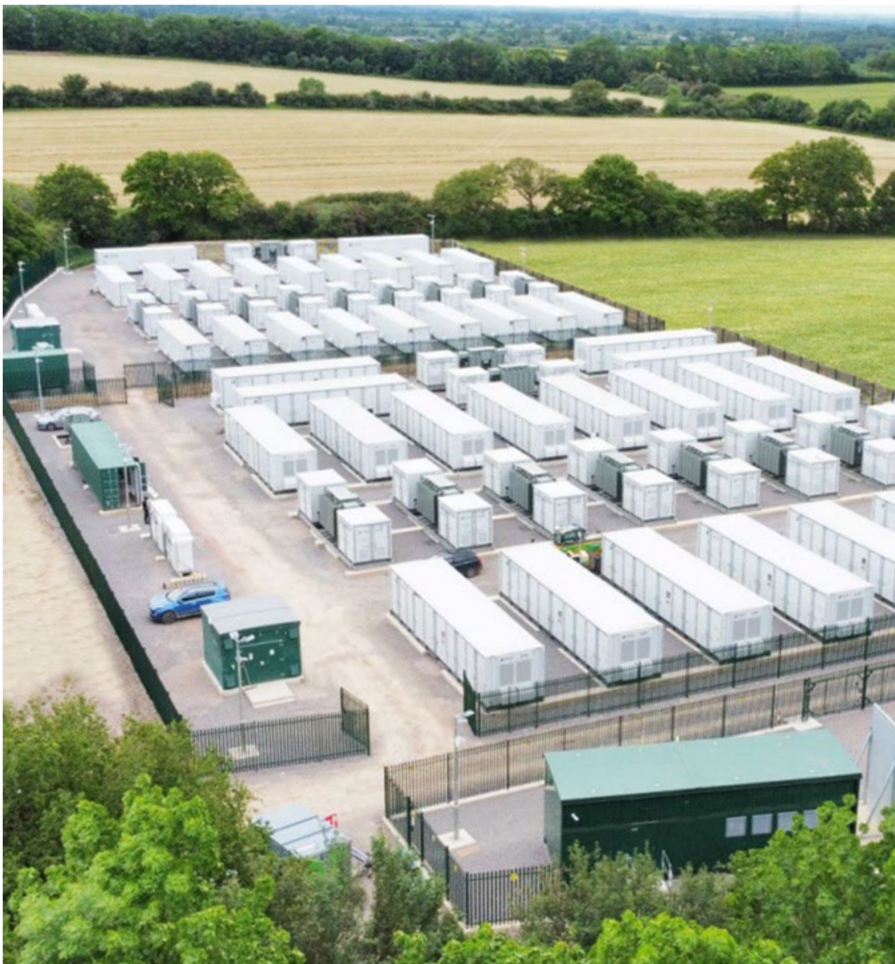
Figur 5-4. Principskitse af batterianlæg, med battericontainere og transformere. Anlægget på fotoet er dog større end det planlagte i Energipark Aktumgaard.
